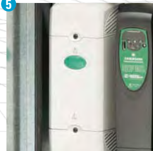
New VSD cubicle
